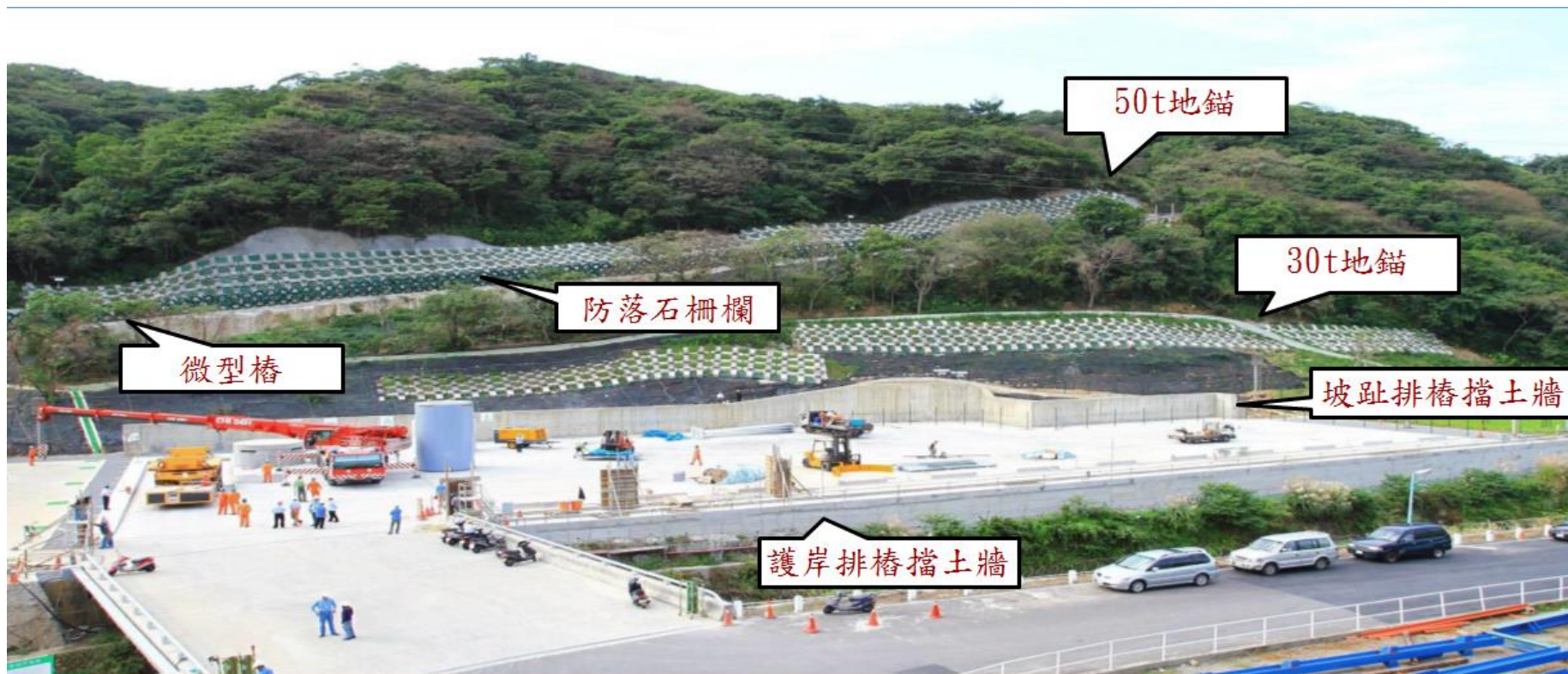
圖1 核一廠乾式貯存-水土保持設施簡介
